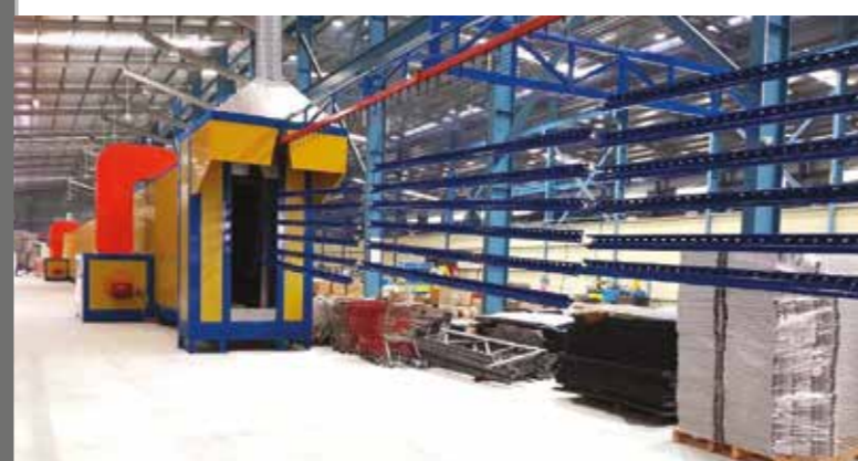
DÂY CHUYỂN SƠN TĨNH ĐIỆN Horizontal Powder Coating Line
